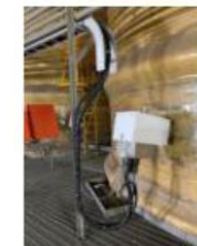
Hg-CEMS (HgT/Hg 0 /Hg 2+ ) 汞 連續監測系統 燃煤火力發電機組
